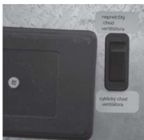
Переключатель режима работы вентилятора
